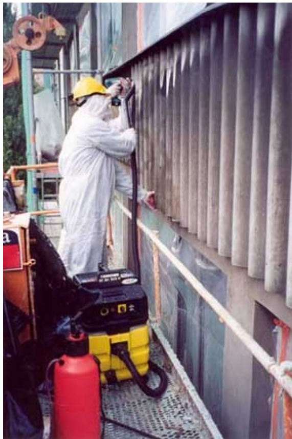
Przykłady budynków z wyrobami azbestowymi:
